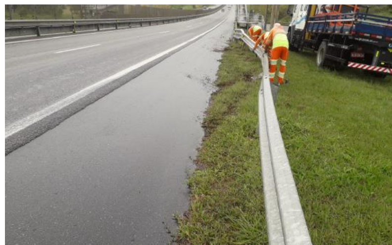
Figura 6.4 ViaLagos – Dispositivo de Segurança – Km 10+140 Norte
